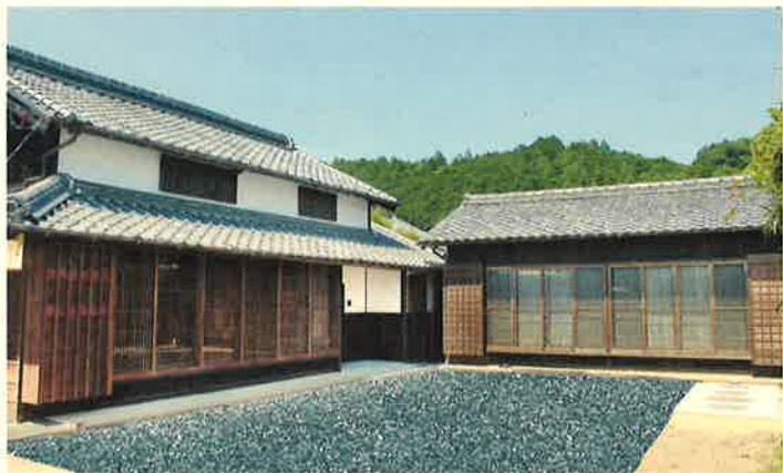
【外観】縦格子の建具を新設することで、母屋(写真左)・離れに一体感を出した。格子は柿渋等の自然系塗料を塗装し、古材と調和させた。
